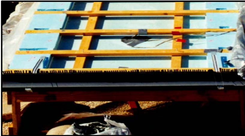
Fig. 3 Posizionamento delle sonde nella sezione in prossimità della gronda. La copertura è stata monitorata in tre sezioni distinte, in corrispondenza della gronda, della falda ed in posizione intermedia.
